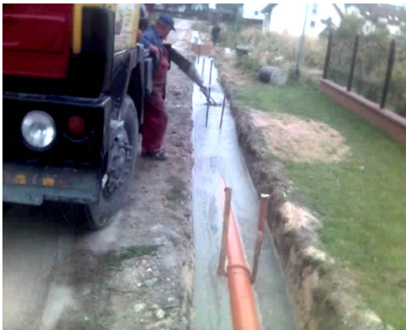
Рис. 8. Прокладання каналізаційних мереж в пінобетоні на глибині 40 см від поверхні (м. Замость, Польща, 2005 р.)
